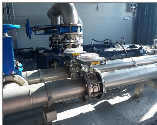
Oczyszczalnia ścieków - Rzeszów.
