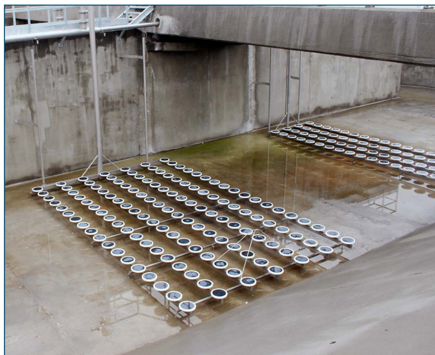
Rys. 5. Instalacja napowietrzania i mieszania ścieków zrealizowana przez Proffico – Oczyszczalnia Ścieków Morąg
