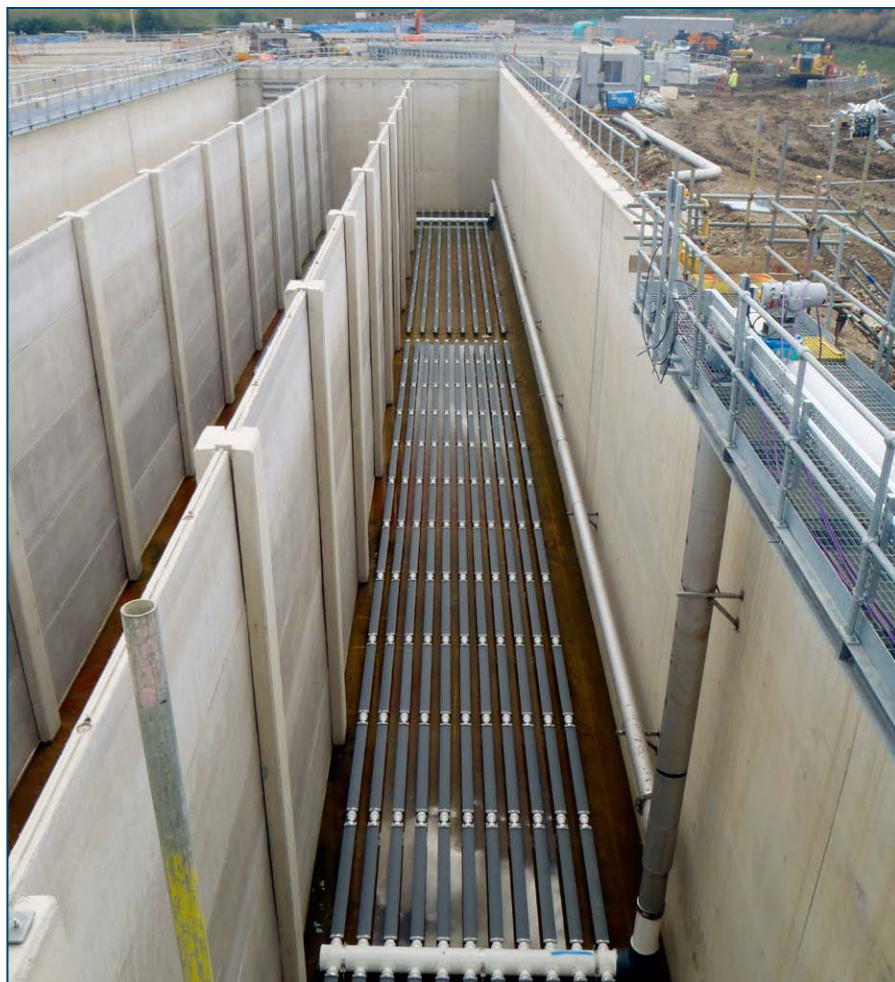
Rys. 4. Instalacja w Londynie – Oczyszczalnia Ścieków Modgen
