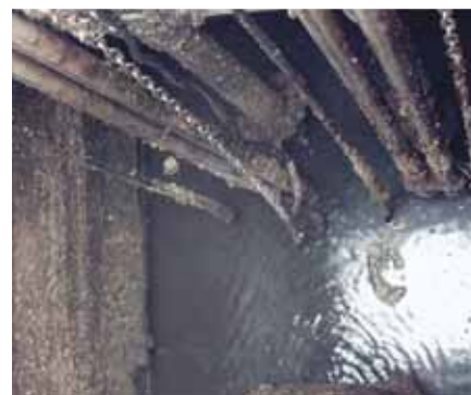
Pompownia dwa tyg. po montażu pomp Concertor
