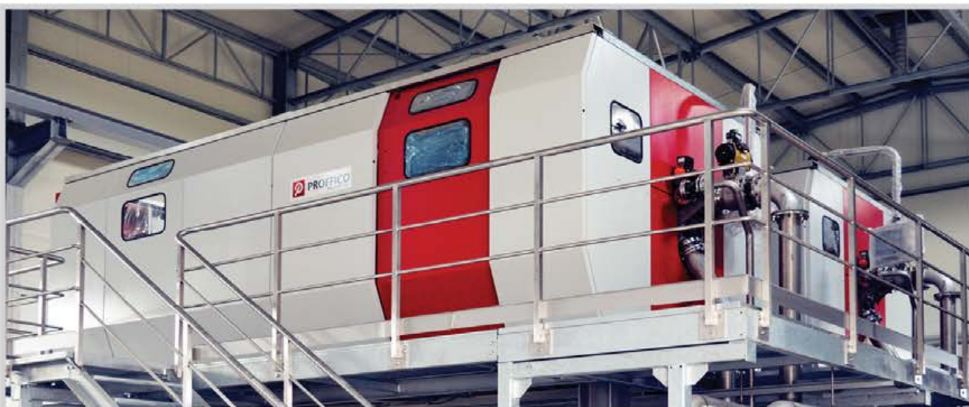
Instalacja odwadniania osadów ściekowych w Radomiu
