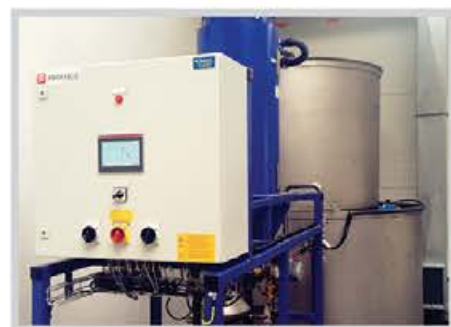
Stacja dozowania flokulantu
