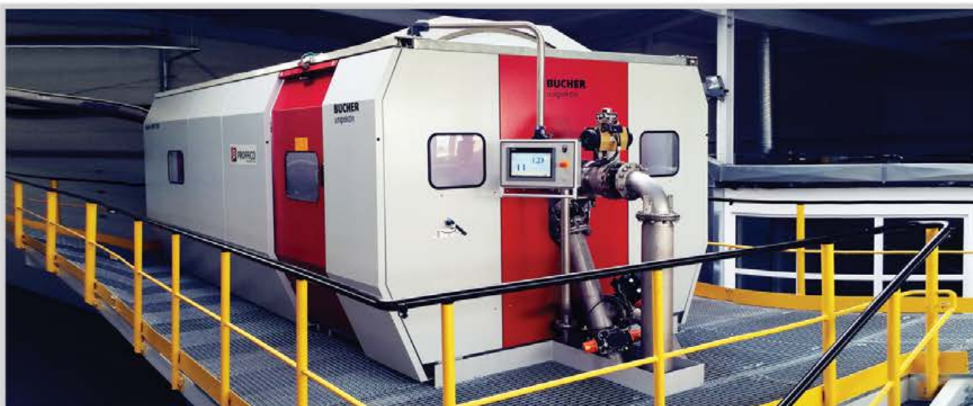
Instalacja odwadniania osadów ściekowych w Puławach
