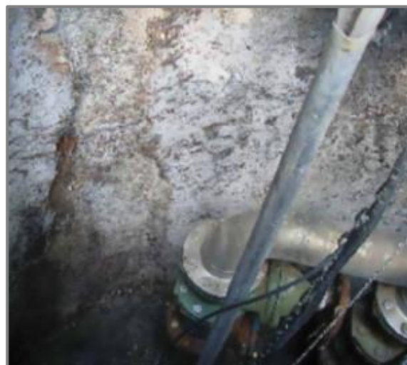
Wpływ siarkowodoru na beton
