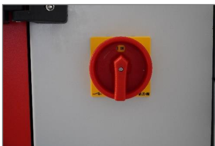
Włącznik główny generatora na zewnątrz obudowy
