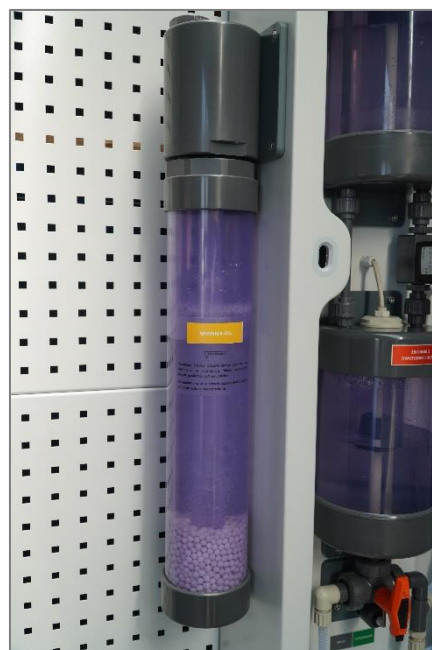
Mokry absorber neutralizujący opary dwutlenku chloru
