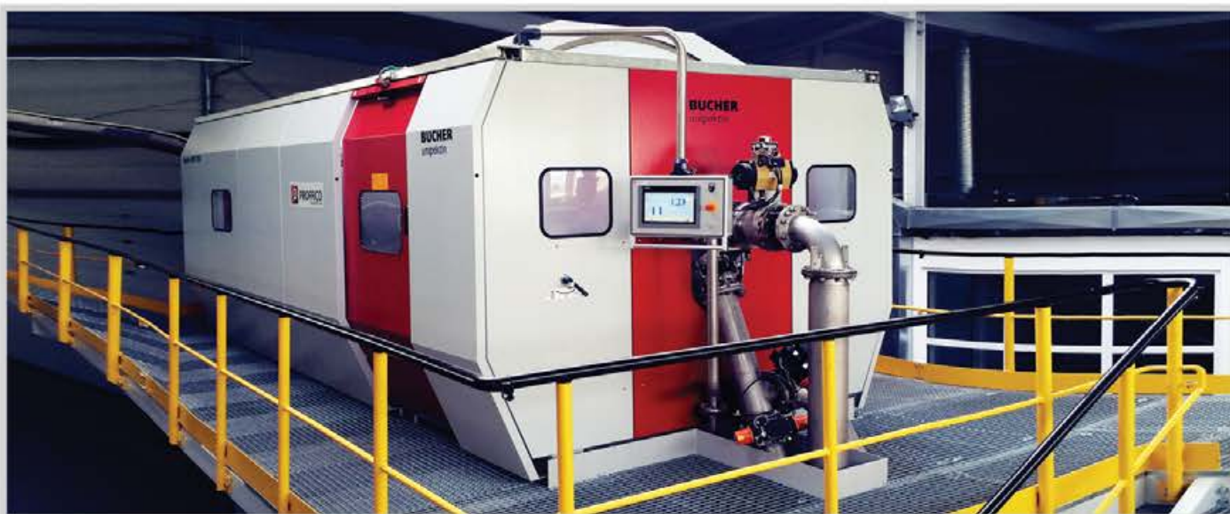
Instalacja odwadniania osadów ściekowych w Puławach
