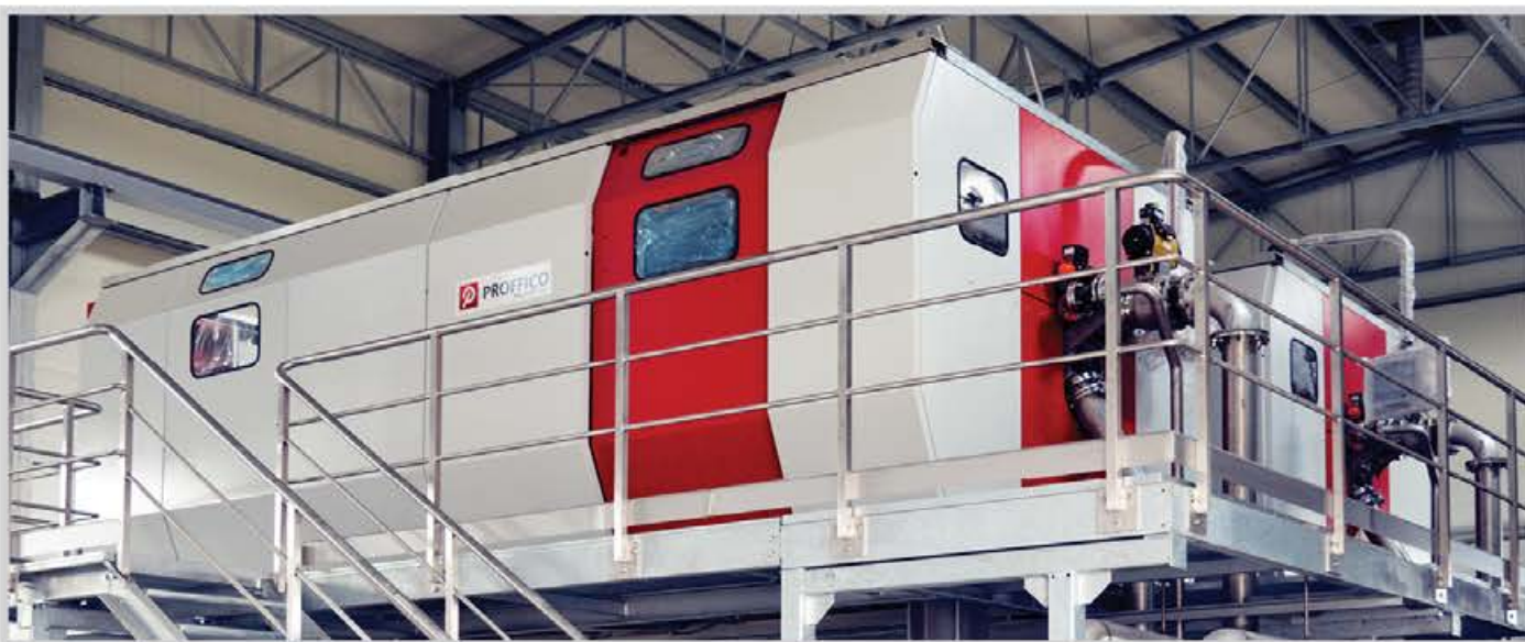
Instalacja odwadniania osadów ściekowych w Radomiu
