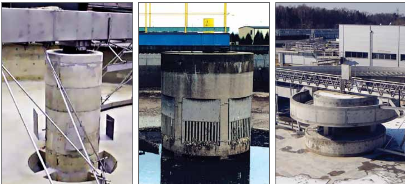
Typowe - stałe kolumny napływu ścieków do osadników
