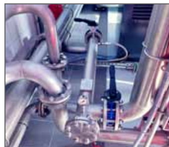
8. uruchomienie układu uzdatniania wody
